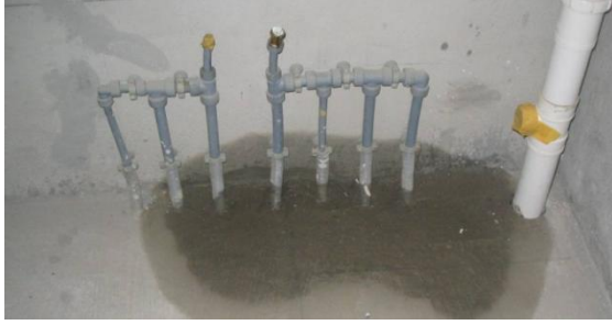
图 10.8.1-1 管道穿楼板处未按要求设置套管和止水环
