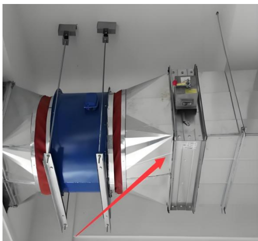
图 11.5.7.1 防火阀未设置支吊架
