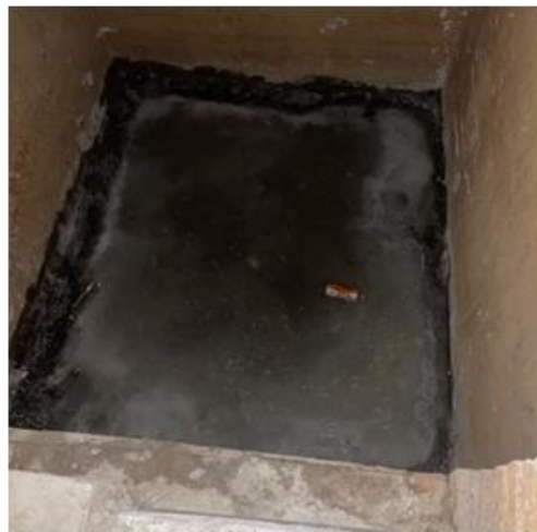
图 10.1.1-4 集水井等底部、侧墙渗漏水
