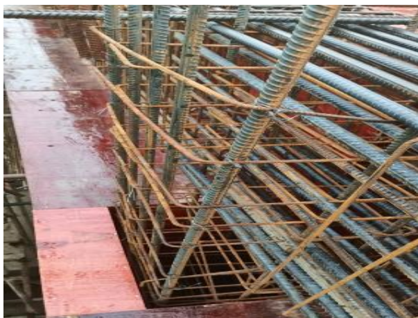
图 5.5.1 梁、柱节点处箍筋位置偏差
