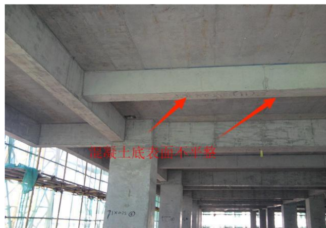
图 6.2.1-2 混凝土底表面不平整
