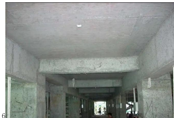
图 6.3.1 混凝土梁底挠度偏大
