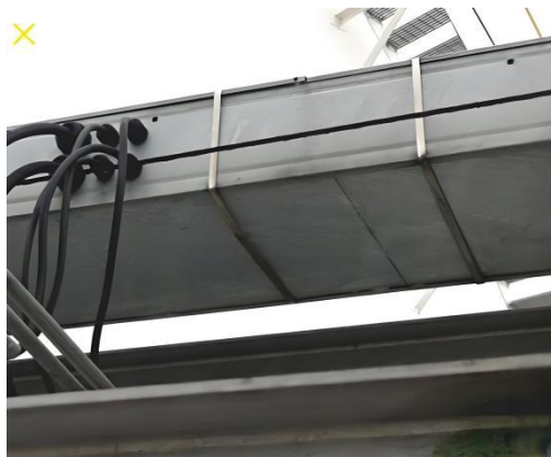
图 11.3.4.1 室外桥架未设置泄水孔
