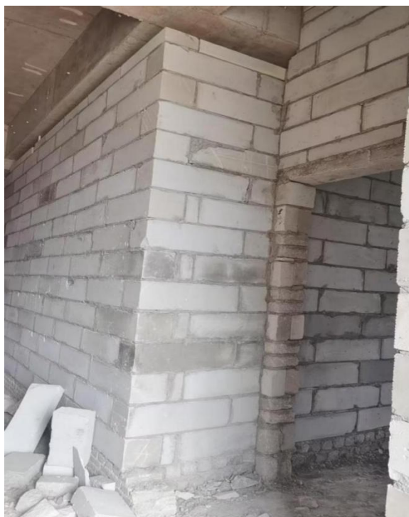
图 8.4-1-3 洞口右侧墙体长度小于 240mm 未设置钢筋混凝土框
