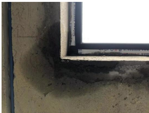
图 10.5.1-1 窗框与结构间封堵不密实渗水
