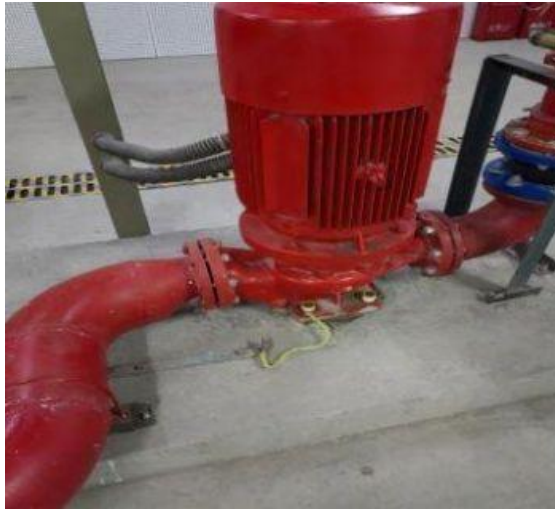
图 11.6.2.1 设备未安装减震器
