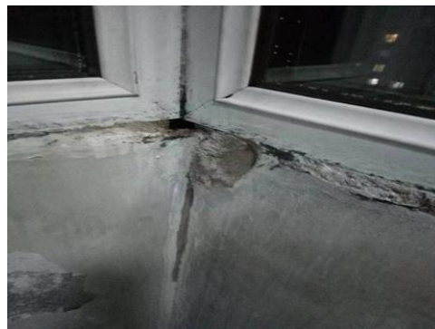
图 10.5.1-4 窗框排水孔堵塞渗水
