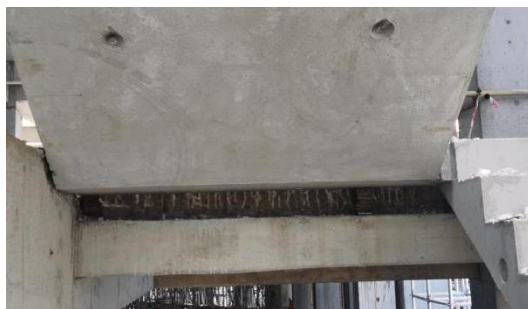
图 7.6.1-1 楼梯安装现浇节点标高错误
