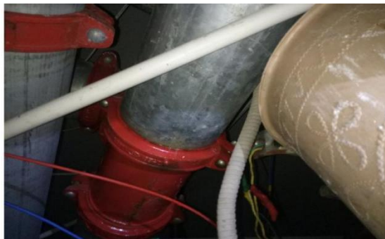
图 10.8.1-5 管道卡箍连接或者焊接连接位置渗漏
