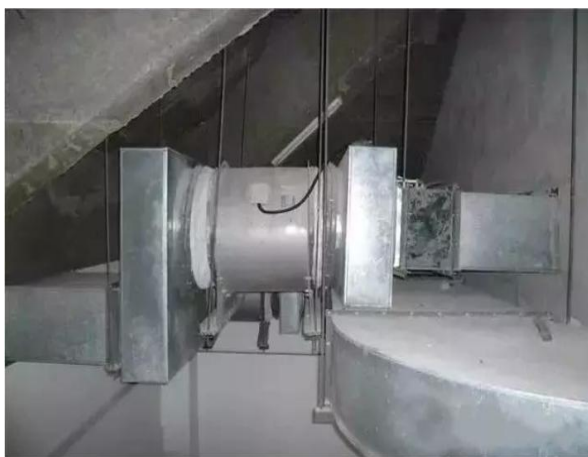
图 11.5.8.1 风管橡胶挠性接头不平整、扭曲、过短
