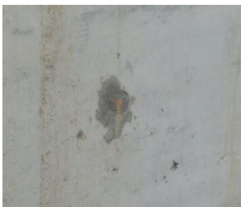
图 10.2.1-5 外墙局部螺杆孔渗漏水
