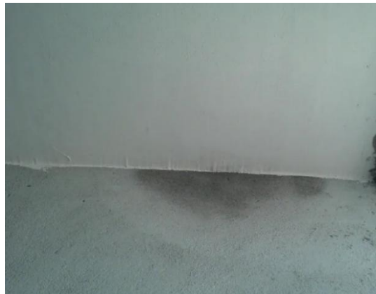
图 10.7.1-2 厨、卫生间板底阴角渗漏
