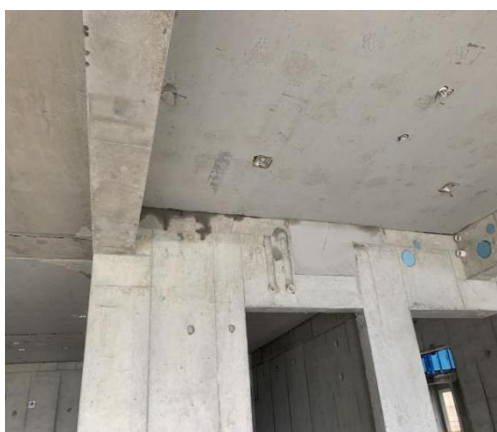
图 10.7.1-3 厨、卫生间梁板交接位渗漏
