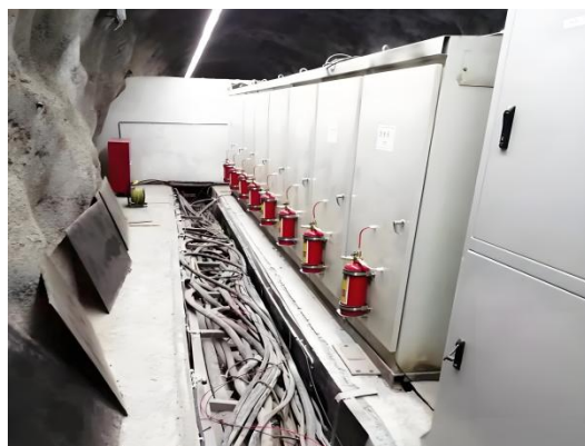
图 11.2.9.2 电缆沟内电缆敷设不规范
