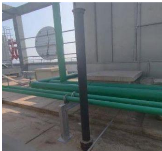
图 11.7.5.1 排气管未做接地
