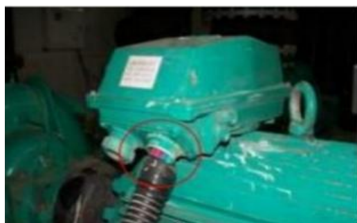
图 12.1.7.1-2 水泵接线软套管未固定好
