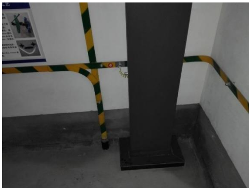
图 11.3.7.3 桥架重复接地
