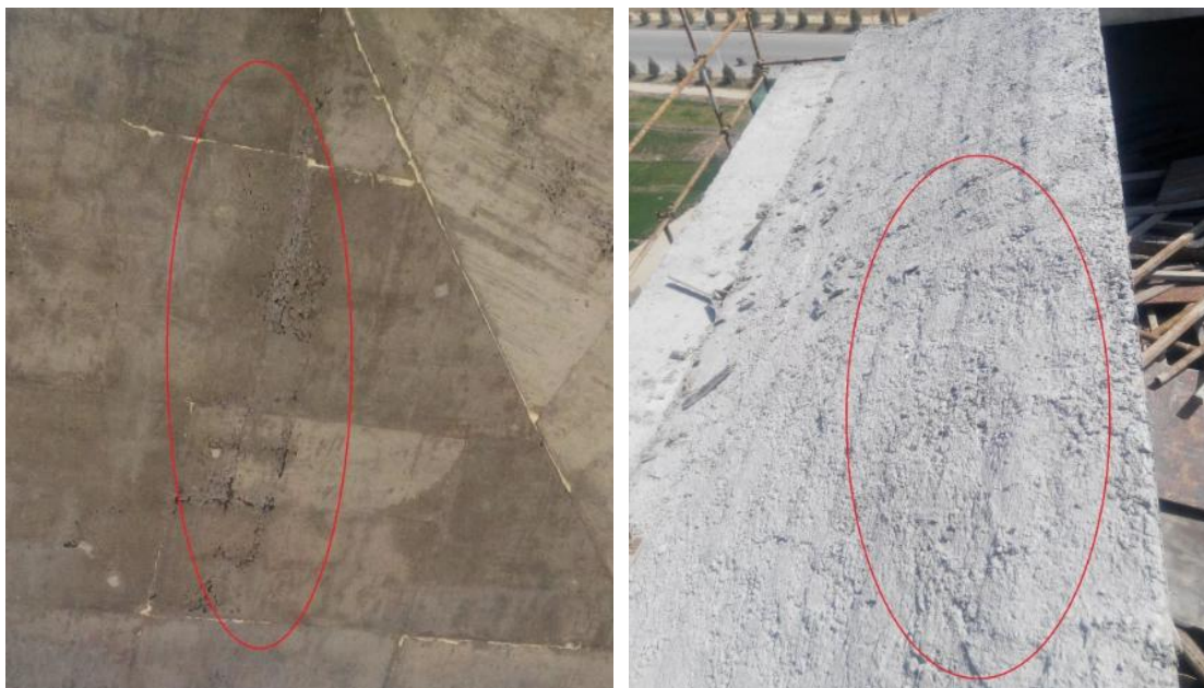
图 6.13.1 现浇混凝土蜂窝、麻面
