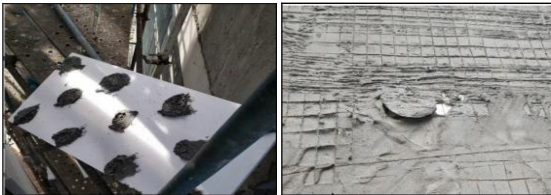
图 13.6-2 粘结砂浆小于 40%、锚栓锚固长度不足、罩面砂浆厚度不足、抗裂措施不到位
