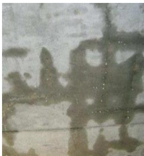
图 10.3.1-2 地下室顶板的表面出现滴答水滴
