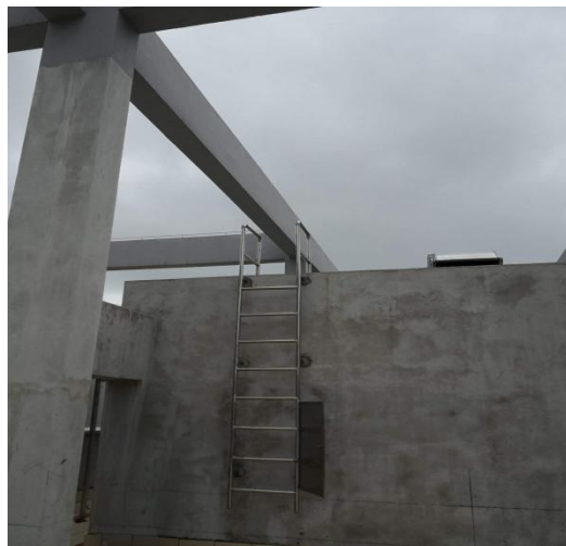
图 11.7.5.1 金属爬梯未做接地
