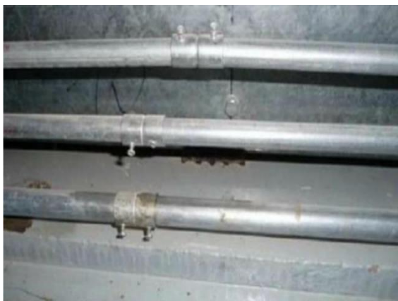
图 11.2.2.1 金属电气线管未接地跨接
