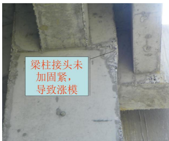
图 6.2.2 梁柱接头处胀模
