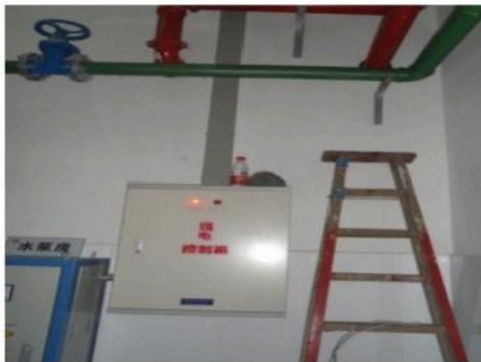
图 12.1.8.1-1 配电箱上方安装平行管道且存在接口
