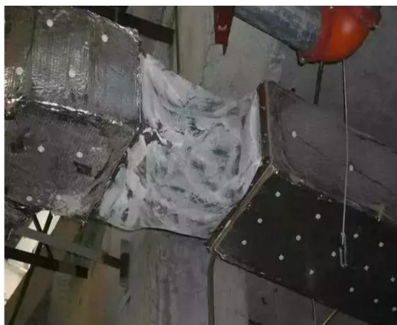
图 11.5.8.2 防排烟系统使用普通橡胶挠性接头
