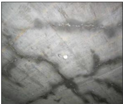
图 10.7.1-1 厨、卫生间底板面存在裂缝
