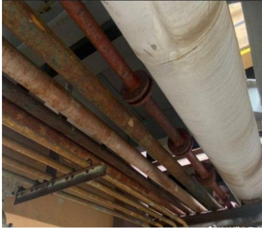
图 11.4.4.1 管道锈蚀严重
