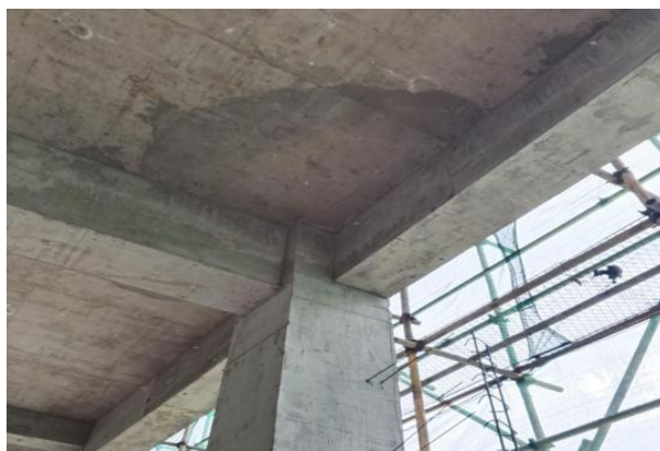
图 6.4.1 混凝土浇筑后形成施工冷缝
