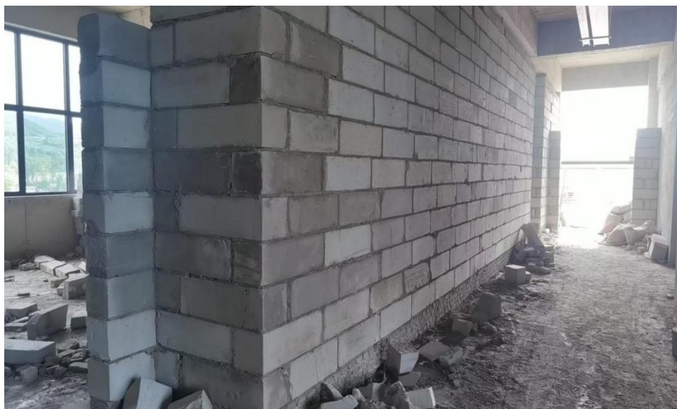
图 8.4-1-1 填充墙长度超过规范未设置构造柱
