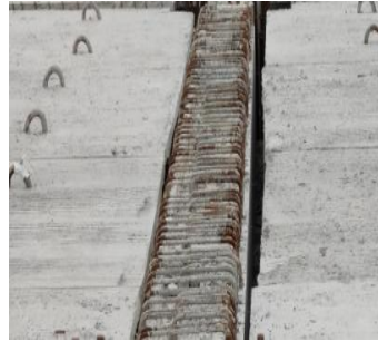
图 7.5.2-1 构件端部弯曲导致安装拼缝较大
