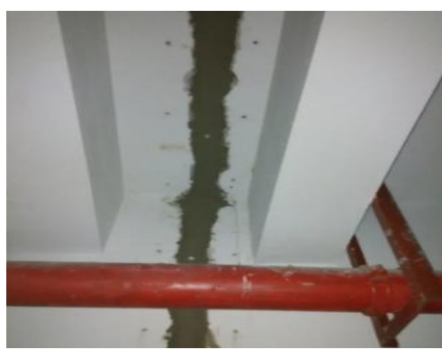
图 10.3.1-4 顶板施工缝等薄弱位置渗漏水
