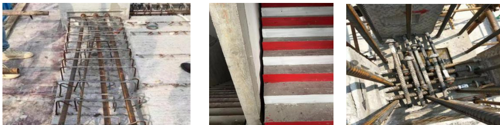
图 7.1.1-1 预埋套筒位置不准确、楼梯与墙体有间隙、梁柱接头纵横向钢筋间距小
