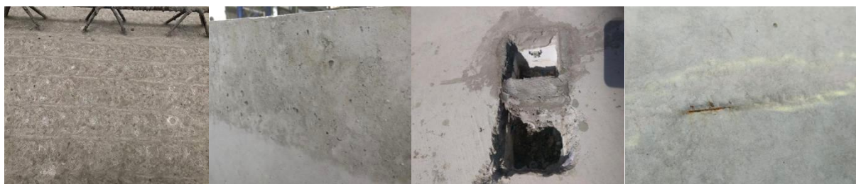
图 7.1.1-3 拉毛深度不足、麻面、预留预埋不规范、露筋
