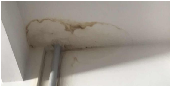
图 10.8.1-3 采暖管道穿楼板处管道洞口堵塞不密实
