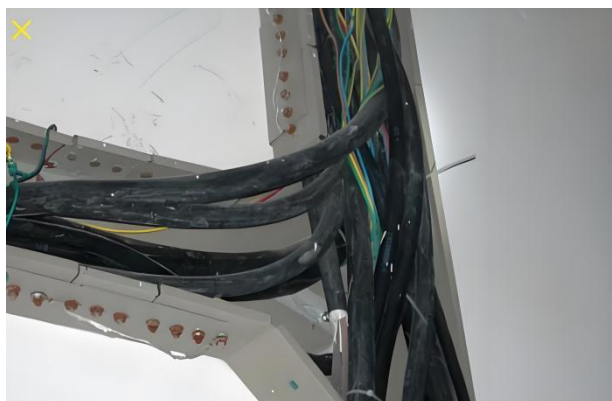
图 11.2.9.1 桥架内电缆敷设不规范
