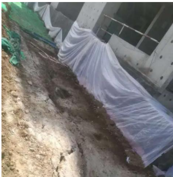
图 4.2.1-2 地下室周边回填区域沉陷破坏
