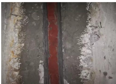
图 10.10.1-1 外墙变形缝处渗水
