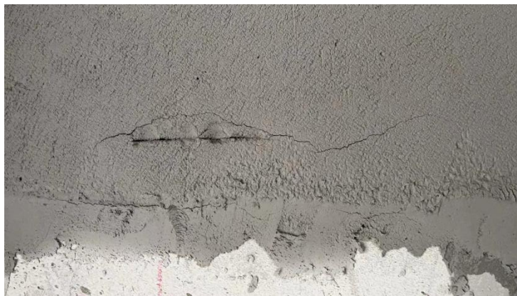
图 9.5.1.1 磷石膏抹灰不规律的裂纹
