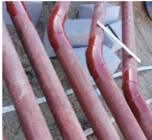
图 11.4.1.2 消防管道连接方式错误
