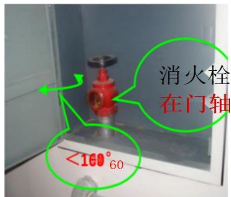
图 12.2.1-2 消火栓安装在门轴侧、门开启角度小
