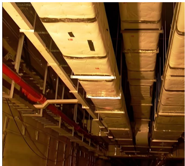
图 11.8.1.2 防排烟风管采用玻璃棉保温（耐火极限高于 3 小时）
