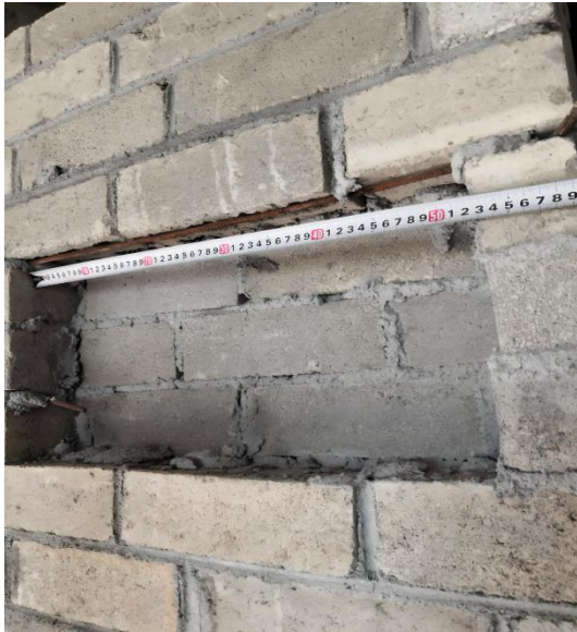
图 11.1.4.1 入户箱顶未设置过梁
