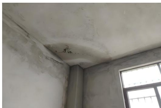
图 10.10.1-2 屋面变形缝渗水污染天棚
