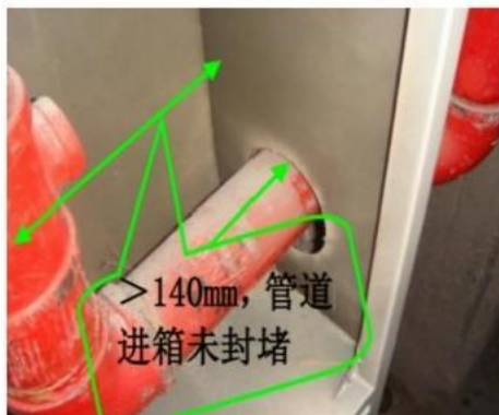
图 12.2.1-1 栓口管道距侧面距离过小
