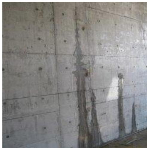
图 10.2.1-2 外墙墙体中部区域裂缝渗漏水
