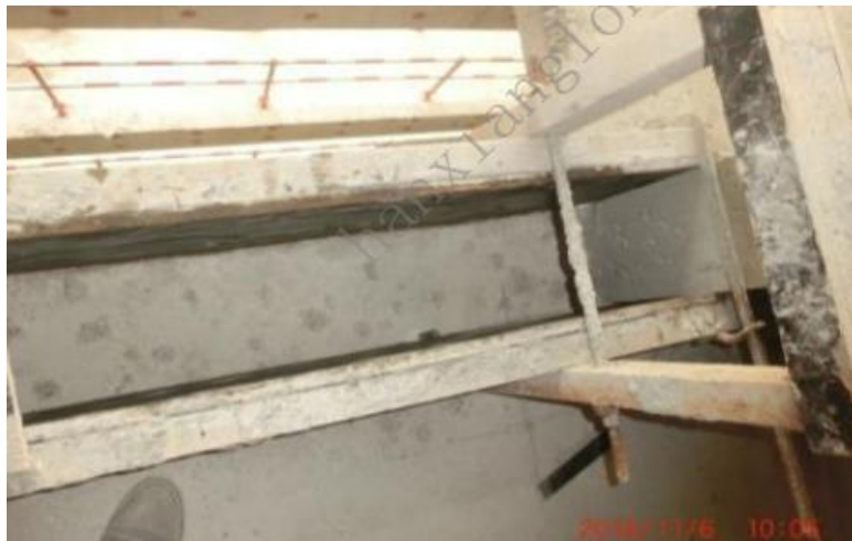
图 6.11.1-2 未对旧混凝土接触面凿毛处理
