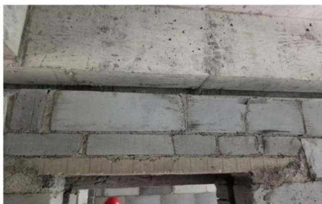
图 8.5.1—1 门窗过梁锚入长度不足
