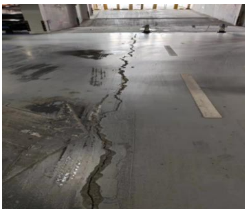
图 10.1.1-1 地下室底板不规则裂缝渗漏水
