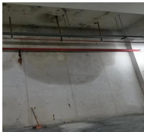
图 10.2.1-4 外墙水平施工缝处裂缝渗漏水
