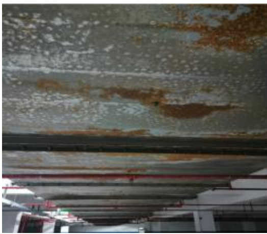
图 11.5.1.1 风管产生锈蚀
