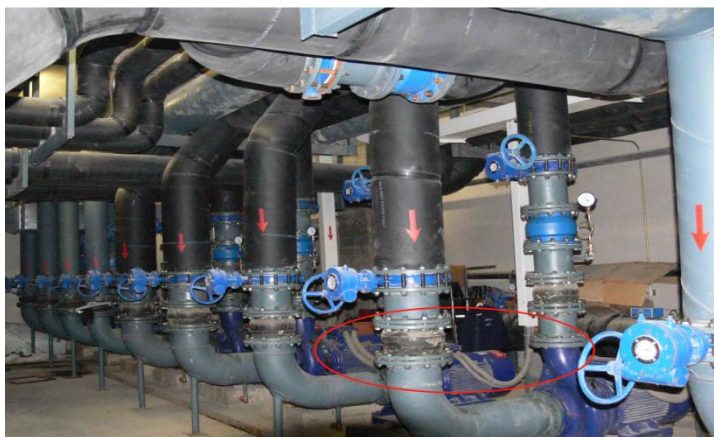
图 11.6.3.1 配管未采用金属软管及专用锁扣接头
