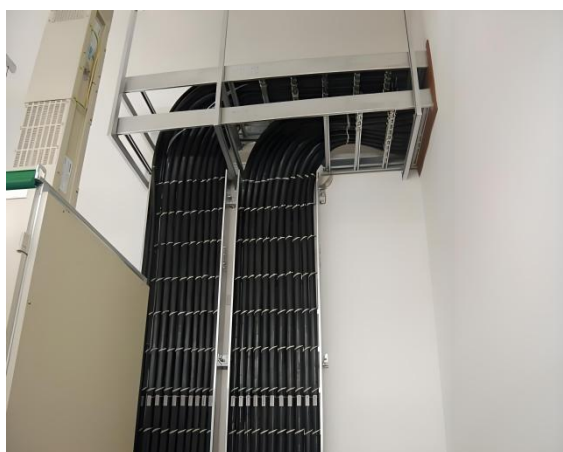
图 11.2.9.3 桥架内电缆敷设
