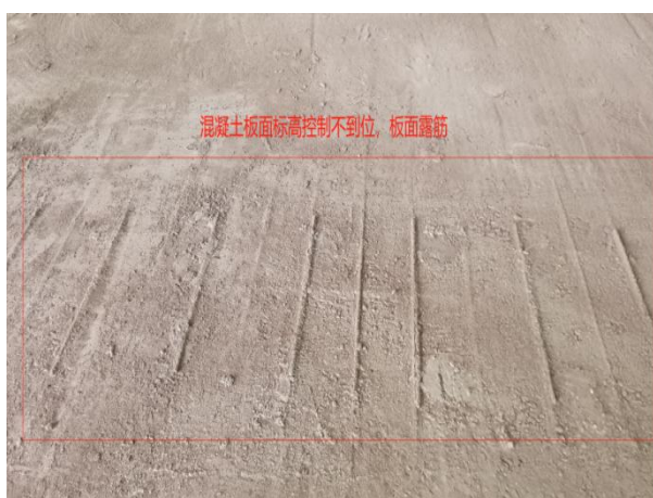
图 5.3.1 混凝土楼板钢筋保护层厚度不足
