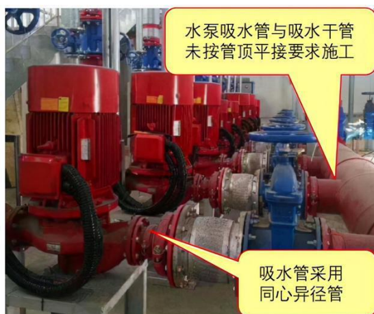
图 12.1.4.1-1 水泵吸水管未顶平安装
