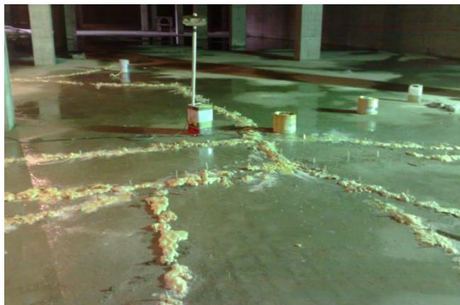
图 4.1.1 地下室底板开裂、渗漏
