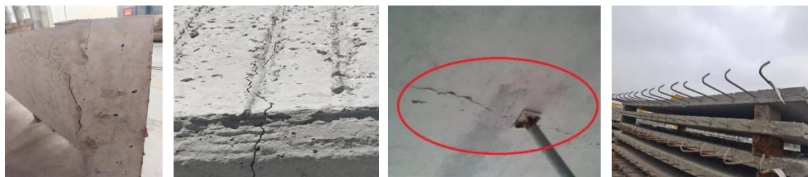
图 7.1.1-4 构件开裂、翘曲
