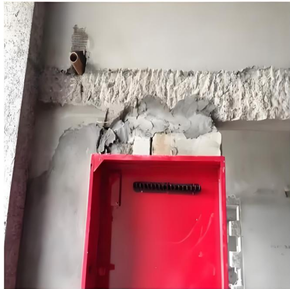
图 11.1.4.2 入户箱顶未设置过梁
