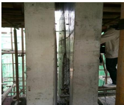
图 6.5.1 变形缝两侧结构柱混凝土胀模
