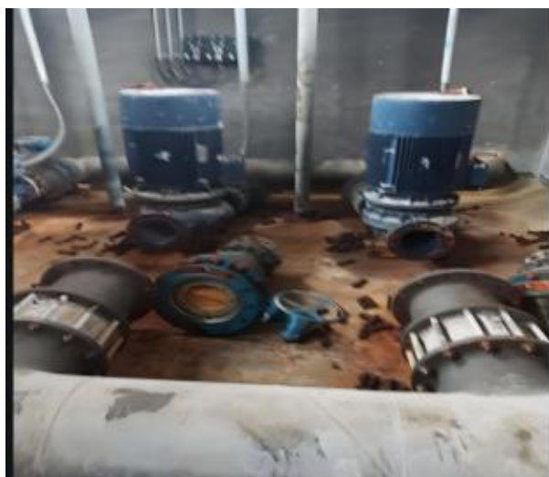
图 11.6.1.1 设备因固定问题拆除重装图
