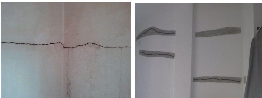
图 8.1.1-2 沿墙的厚度、长度方向贯穿水平裂缝
