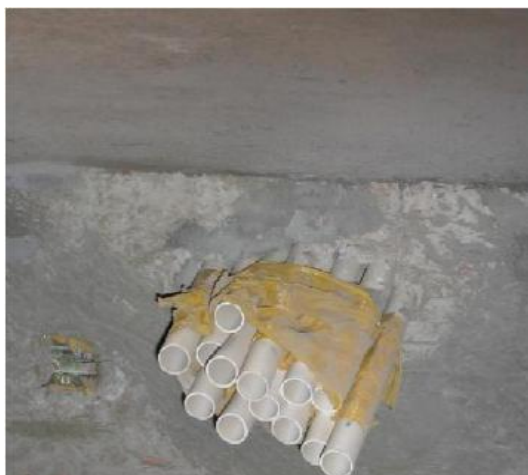
图 11.1.2.1 PVC 管集中在梁的局部
