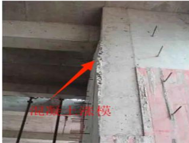
图 6.2.1-1 混凝土柱胀模
