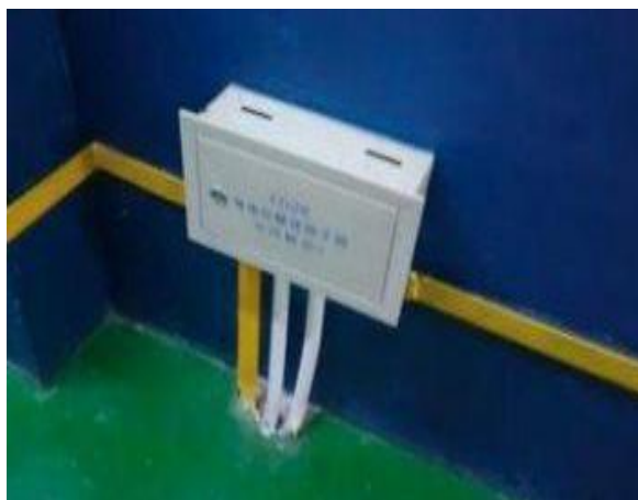
图 11.7.1.1 等电位箱安装错误
