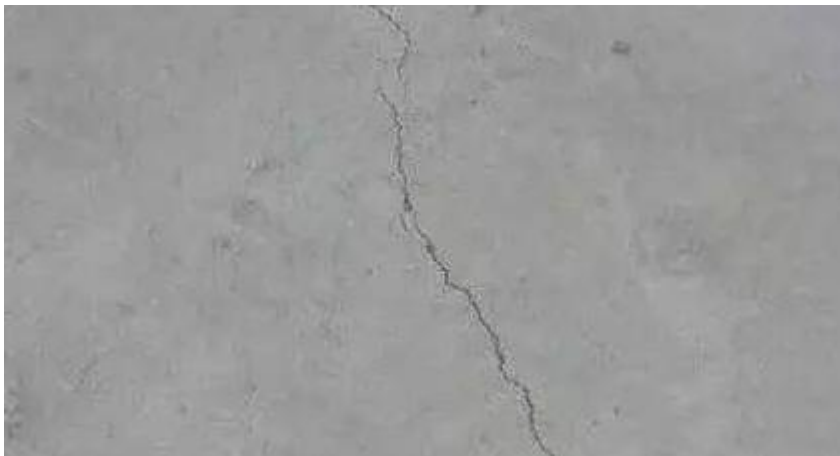
图 13.3-1 地面出现明显的裂缝
