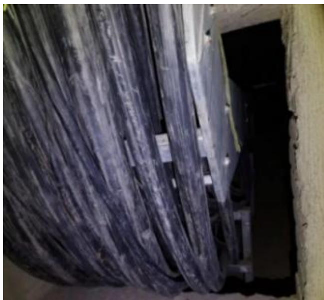
图 11.3.2.1 桥架穿墙等处未设置套管
