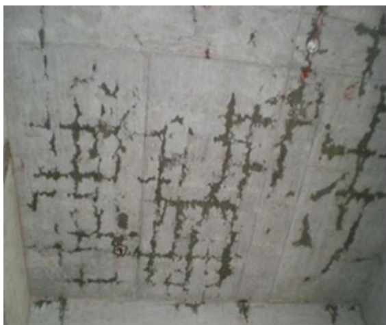
图 10.6.1-1 屋面存在大量龟裂纹渗水
