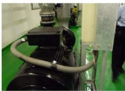
图 12.1.7.1-1 电缆接线未设置防水弯
