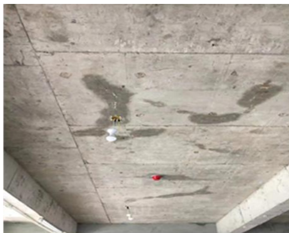
图 10.6.1-2 屋面预埋管线位置渗漏水
