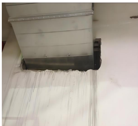
图 11.5.5.1 风管穿墙未安装套管
