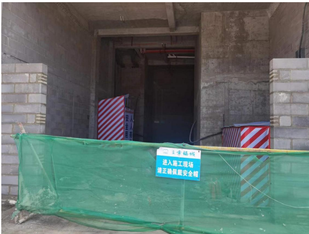
图 8.4-1-2 大洞口两侧未设置构造柱
