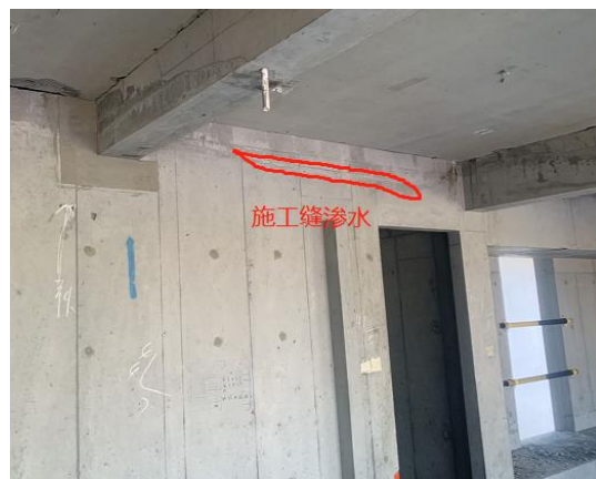
图 10.7.1-4 厨、卫生间降板交接位渗漏
