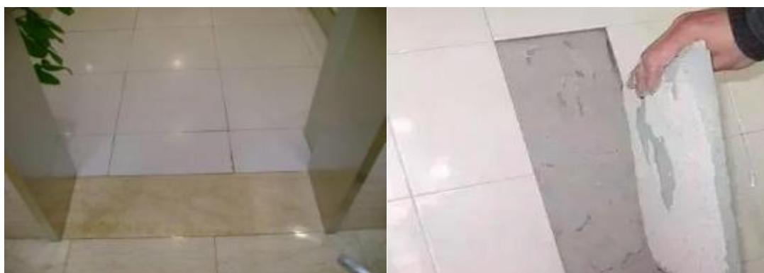
图 13.4-1 地砖出现空鼓、脱落
