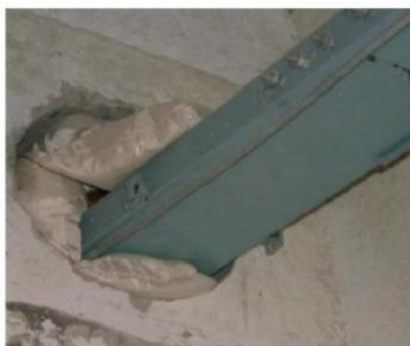
图 12.6.3.1 桥架穿墙洞过大且未设置套管
