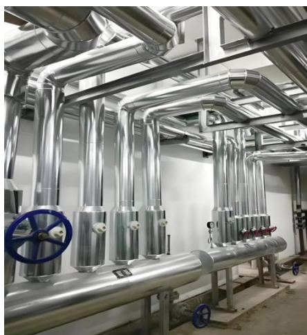
图 11.8.1.2 保温隔热管道间距合理
