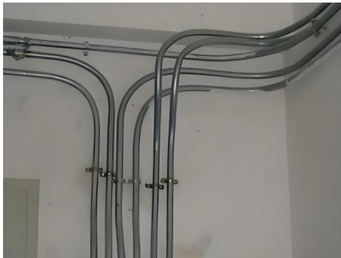
图 11.2.4.1 电气线管连续翻弯未设置过线盒
