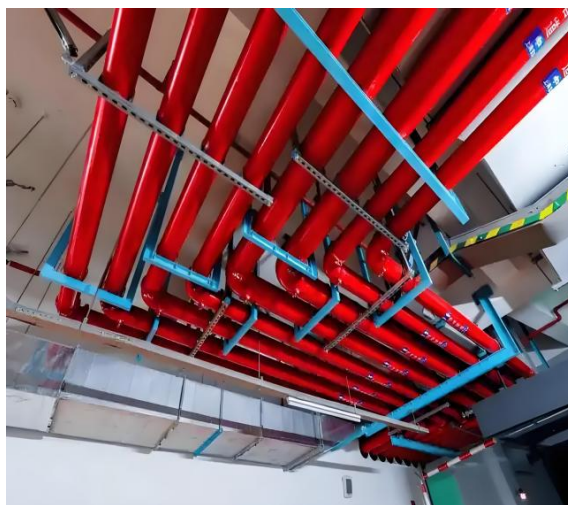
图 11.4.3.6 管道支架布置合理
