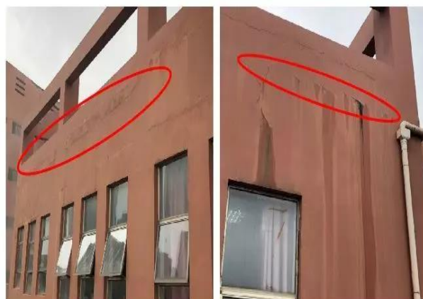
图 10.6.1-4 女儿墙根部渗水
