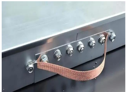
图 11.3.7.4 桥架接地跨接
