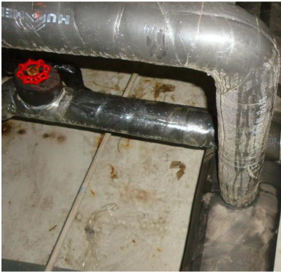
图 11.8.1.1 水管采用玻璃棉保温
