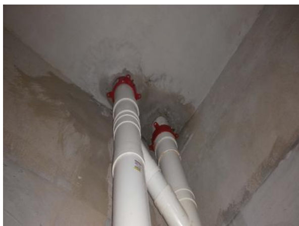
图 10.6.1-3 出屋面管道周边渗水
