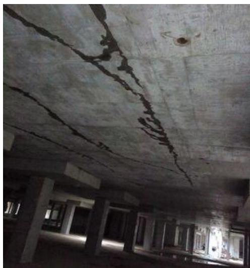
图 10.3.1-1 地下室顶板的表面出现水渍、湿斑
