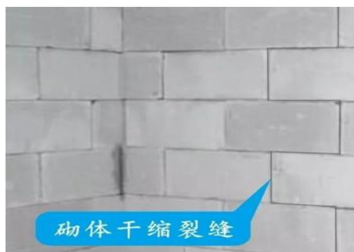
图 8.1.1-3 干燥收缩裂缝
