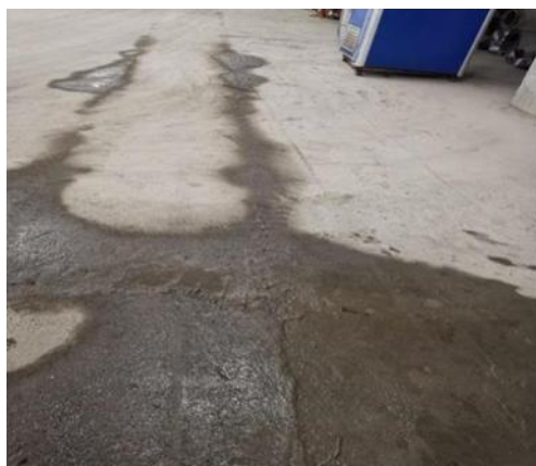
图 10.1.1-2 底板薄弱部位裂缝渗漏水
