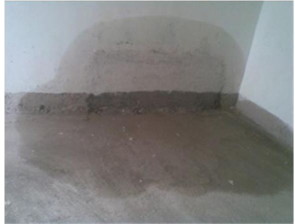
图 10.4.1-2 墙根潮湿、渗水
