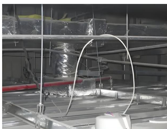
图 11.2.6.2 密闭吊顶内超长使用软管
