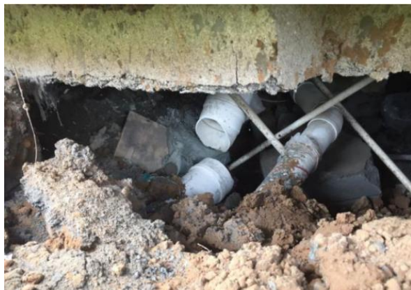
图 4.2.1-1 管线与建筑接口部位的断裂破坏
