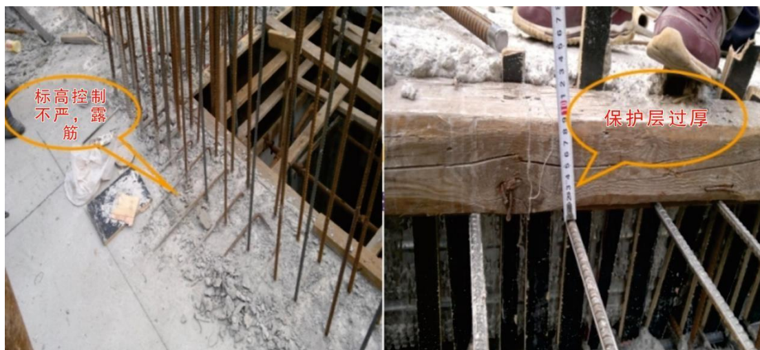
图 6.8.1-1 混凝土标高偏差过大
