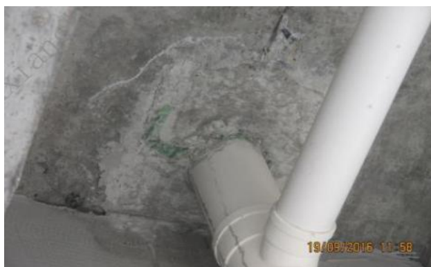
图 6.11.1-1 未按要求预埋穿墙、穿楼板套管
