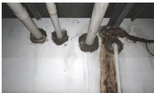
图 10.9.1-1 地下室排水出户管穿外墙套管及周边渗漏
