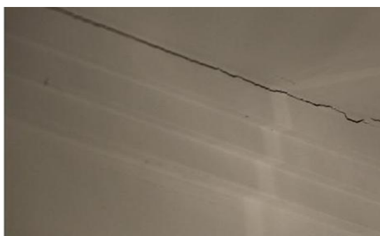
图 8.1.1-1 填充墙顶部与承重主体结构接触处产生水平裂缝
