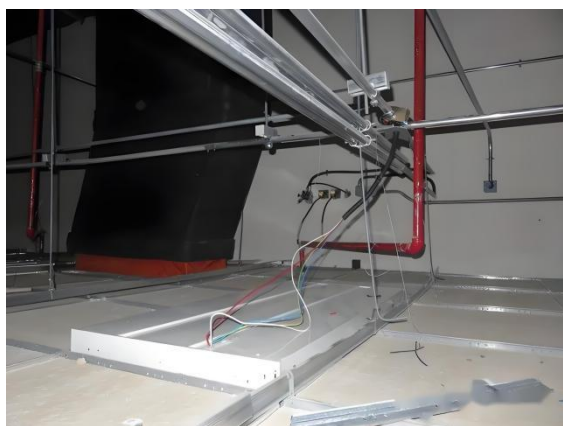
图 11.2.6.1 密闭吊顶内裸线敷设
