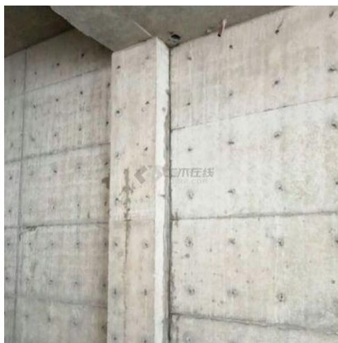
图 10.2.1-1 扶壁柱边缘竖向裂缝渗漏水
