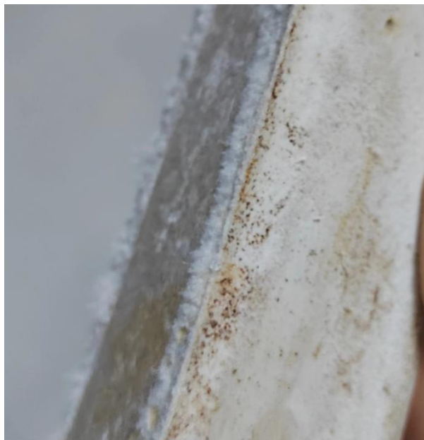
图 9.2.1.1 石膏墙体从内而外析出晶体，形成盐霜、泛碱
