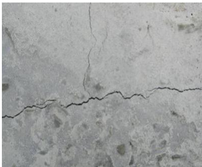
图 6.14.1.1 大体积混凝土裂缝
