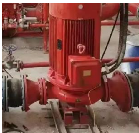
图 12.1.1.1-2 缺乏相应基础及减震措施
