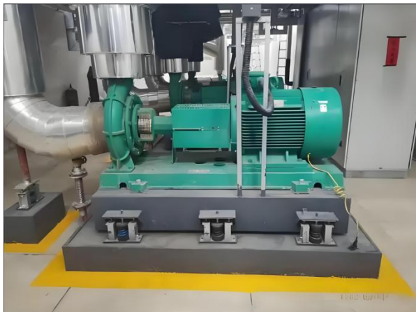
图 11.6.1.4 设备安装位置合理
