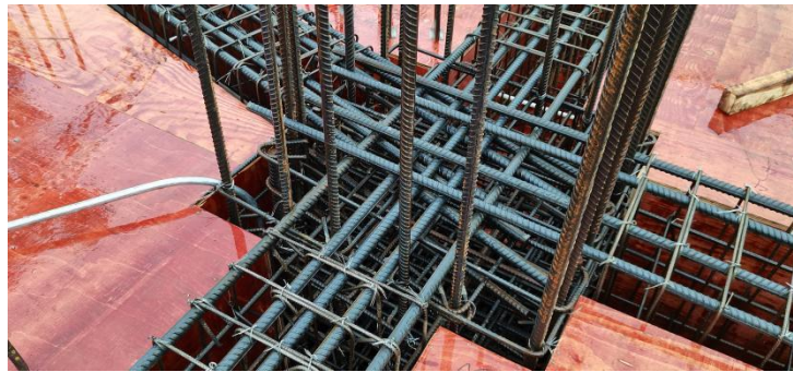
图 5.4.1 主次梁交接处加密区箍筋漏设
