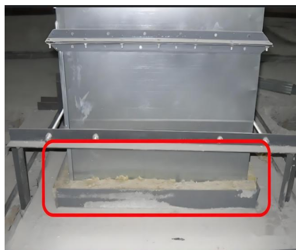
图 11.5.5.2 未用不燃柔性材料封堵
