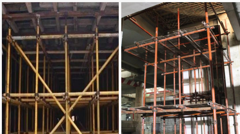
传统架管搭设方式稳定性不足
